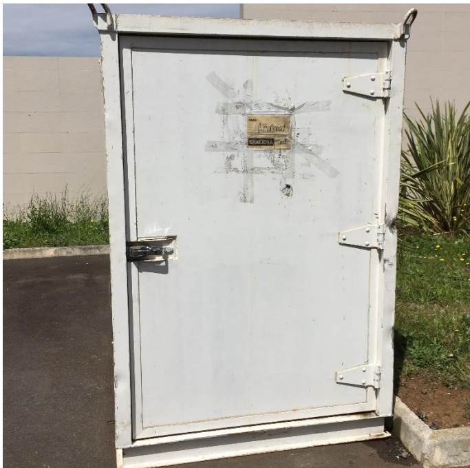
Foto 1 – Vista do contentor refrigerado não trancado.
