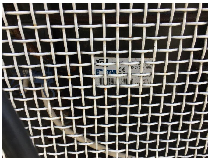
Foto 4 – Compressor do contentor refrigerado.
