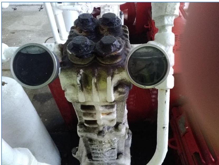
Figura 5.2: Manómetros de compressor de GPL.
