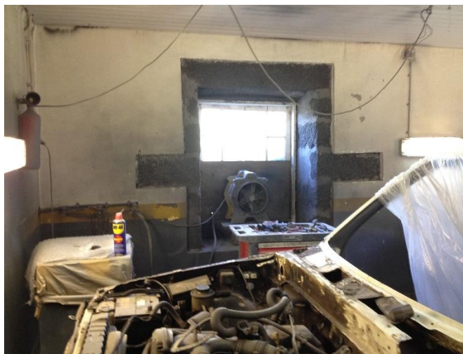
Foto 3 – Exaustão do ar da garagem efetuado por uma janela com auxílio de ventilação forçada.
