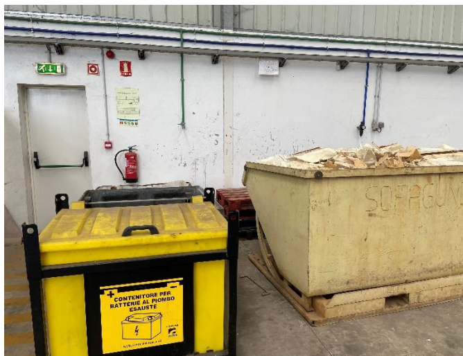
Foto 6 – Baia com resíduos cuja identificação é diferente da tipologia de resíduos armazenados.
