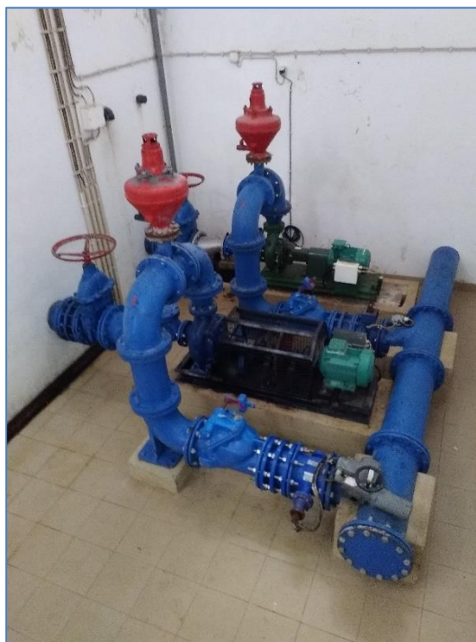
Figura 2.3: Estação de bombagem.
