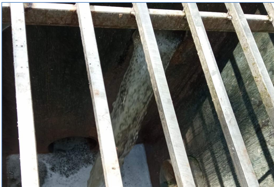
Figura 2.2: Descarga do efluente na caixa próxima da ETARI (a poucos minutos do início da descarga).
