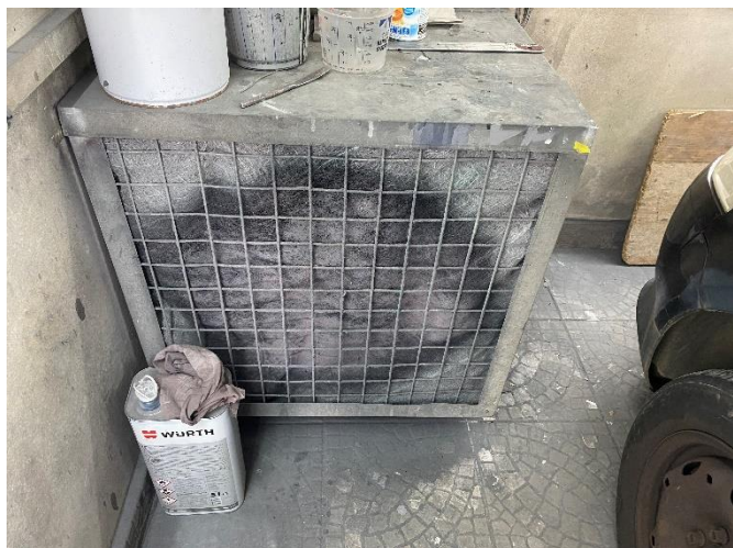
Foto 1 – Exaustor no lado esquerdo da câmara de pintura.
