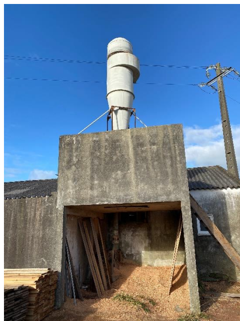
Foto 6 – Ciclone e reservatório superior e baia de cargas dos cavacos e serrim.
