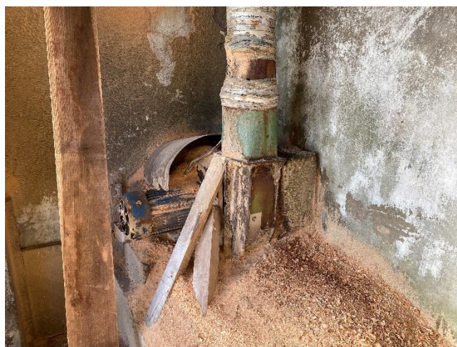
Foto 4 – Bomba do ciclone que aspira os cavacos e serrim para o reservatório superior.
