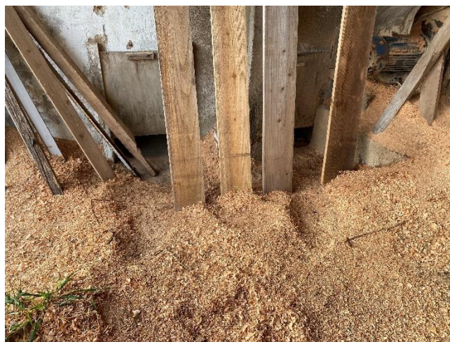
Foto 2 – Saídas do sistema de exaustão da cabine, diretamente para a baía dos cavacos e serrim.
