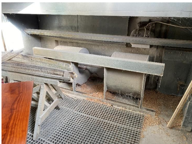
Foto 1 – Sistema de exaustão no interior da cabine de pintura.
