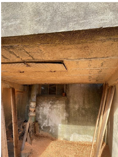
Foto 5 – Sistemas de exaustão soprando diretamente na baia dos cavacos e serrim e alçapão do reservatório superior mal fechado.
