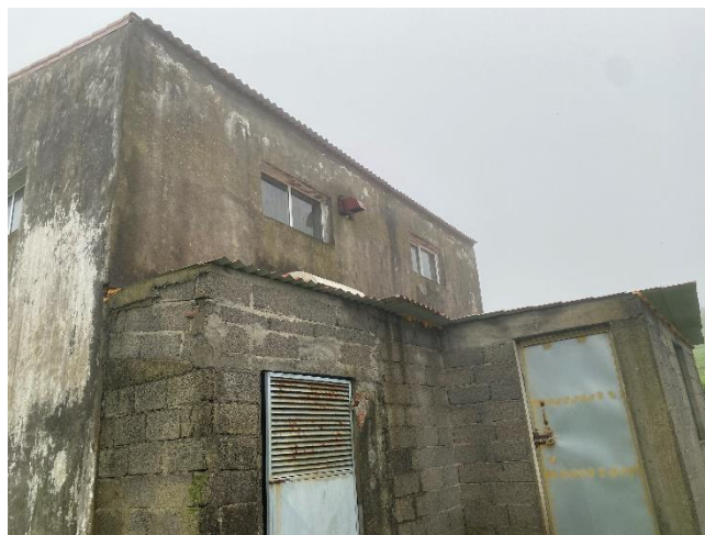
Foto 10 – Exaustão do queimador da cabine, no cimo da fachada, sem chaminé.
