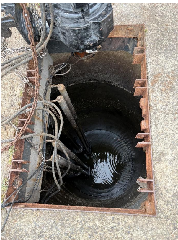
Figura 2 – Poço de bombagem e a nova bomba a ser instalada.
