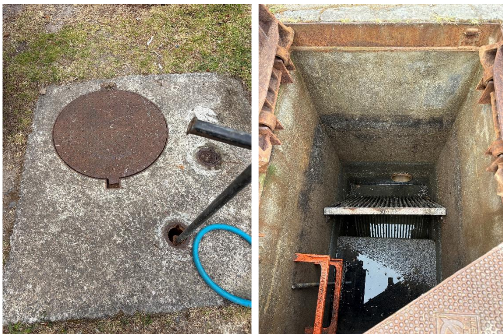
Figuras 3 e 4 – Zona de fecho da válvula e sistema de gradagem de sólidos, a montante do poço de bombagem.
