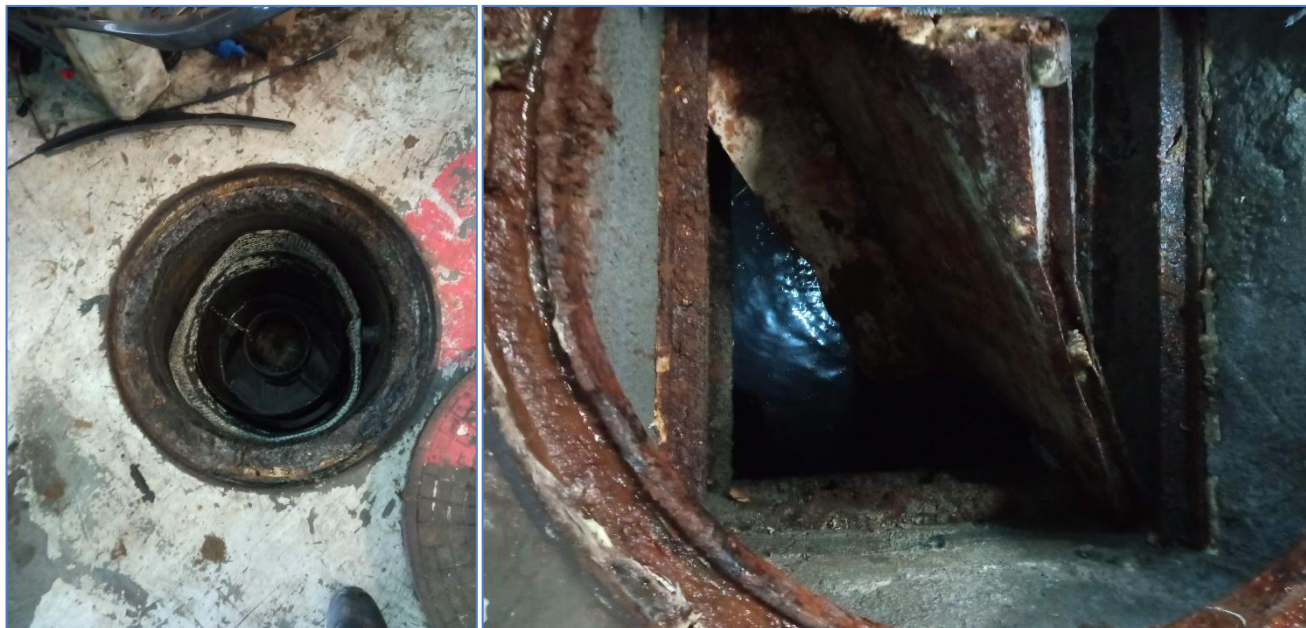
Figura 4.1: Separador de hidrocarbonetos (esquerda) e poço sumidouro (direita).
