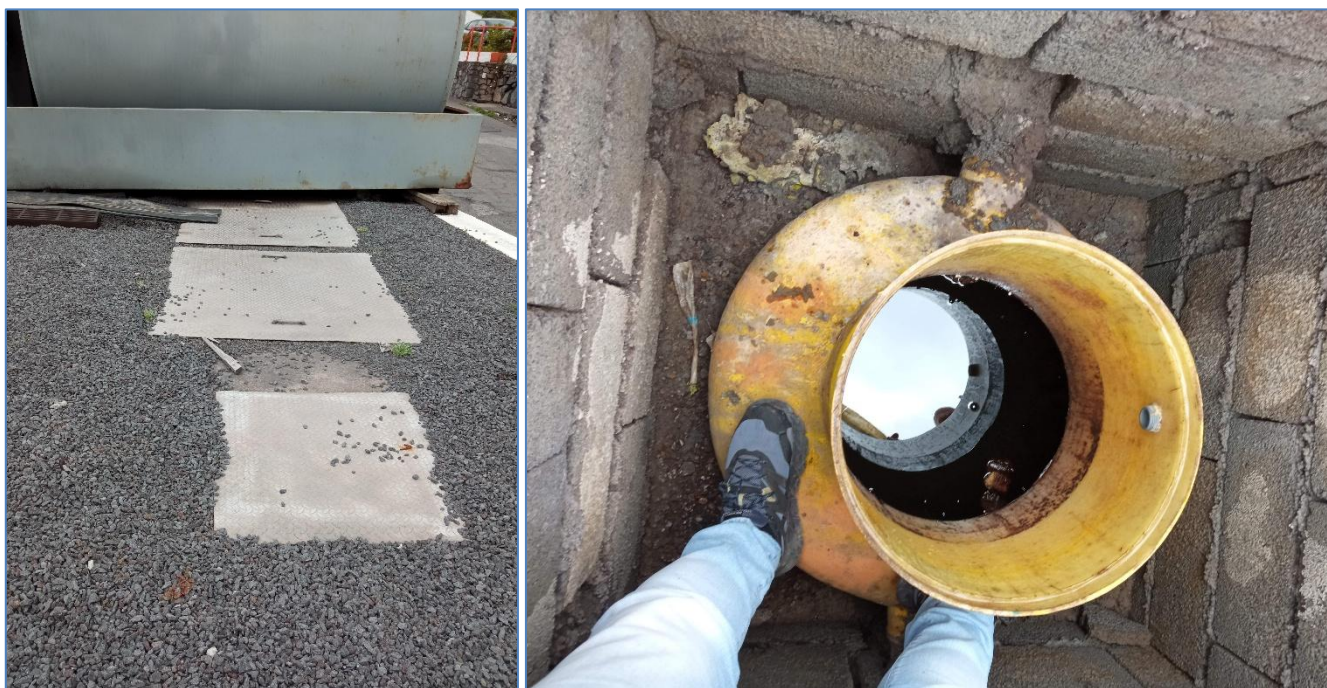
Figura 5.1: Separador de hidrocarbonetos.
